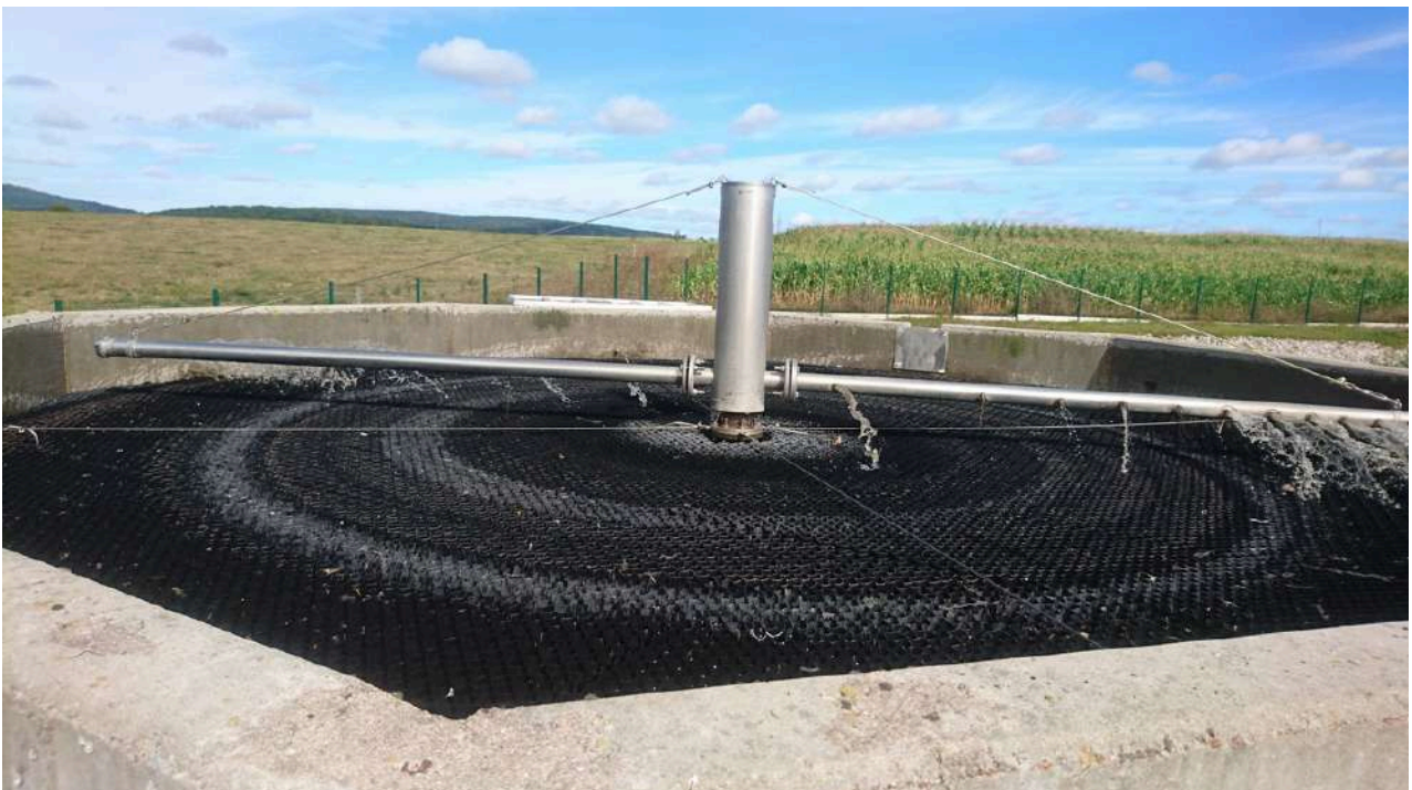
Station d'épuration de Pouligny
