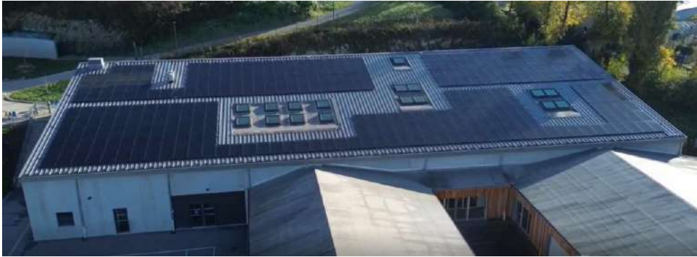
Panneaux photovoltaïques installés sur la toiture du bâtiment de l'école maternelle et du périscolaire Monts et Vallées à Baume les Dames
